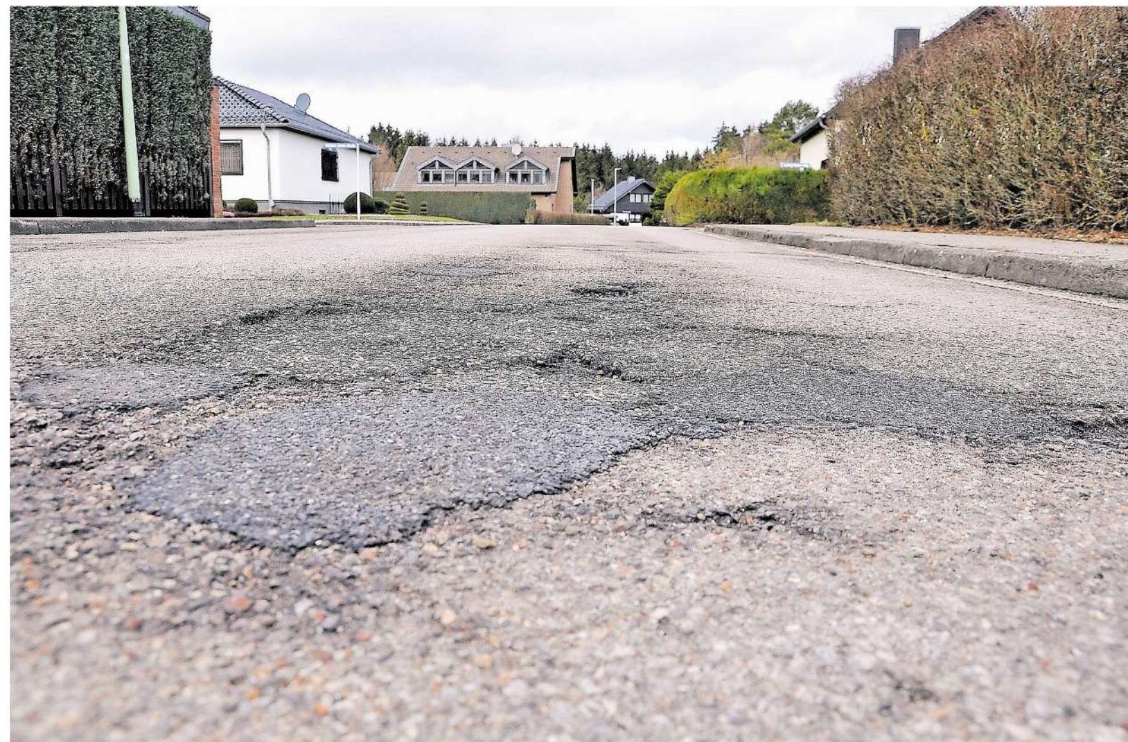
Weitestgehend Einigkeit herrschte bei den Haushaltsberatungen der Gemeinde Simmerath in der Frage, ob mehr Geld für die Instandsetzung und -haltung von Gemeindestraßen ausgegeben werden soll. Die lange Prioritätenliste mit vielen schadhafte Straßen (wie hier im Lammersdorfer Kämpchen) veranlasst die Politik, hier noch tiefer in die Tasche zu greifen.
